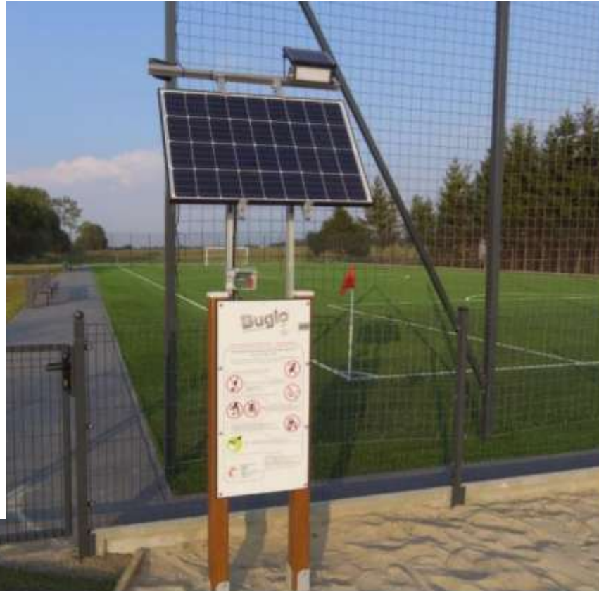
Ryc. 18. Pylon z czujnikiem jakości powietrza i reflektorami, instalacją fotowoltaiczną oraz regulaminem placu zabaw
